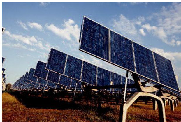
Centrale solaire de Montesquieu conçue et installée par EXOSUN
