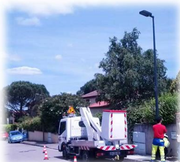
Pose d'un luminaire intégrant un module Kara
